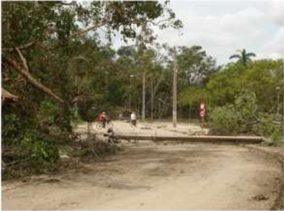
Fig. 1 Postes eléctricos derribados en Casino Campestre. Ciclón Ike-2008 Fuente: Joaquín López
