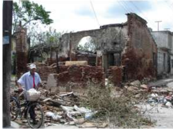
Fig. 6 Derrumbes producidos por intensas lluvias. Ciclón Ike-2008 Fuente: Joaquín López
