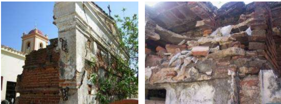
Fig. 2 y 3 Panteón adosado a panteón en Primer Tramo, nótese el desplome de los muros y entrepisos que conforman una de las zonas de enterramiento con pérdida de sus elementos estructurales, arquitectónicos y decorativos. Vista lateral y detalle de la fachada principal.
