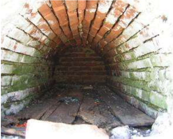
Fig. 9 Nicho sin cubrir en panteón adosado a pared. Material constructivo ladrillo de barro y mortero, fíjese la pérdida del mortero de unión entre ladrillo, producido por el efecto del tiempo y la ausencia de mantenimiento.
