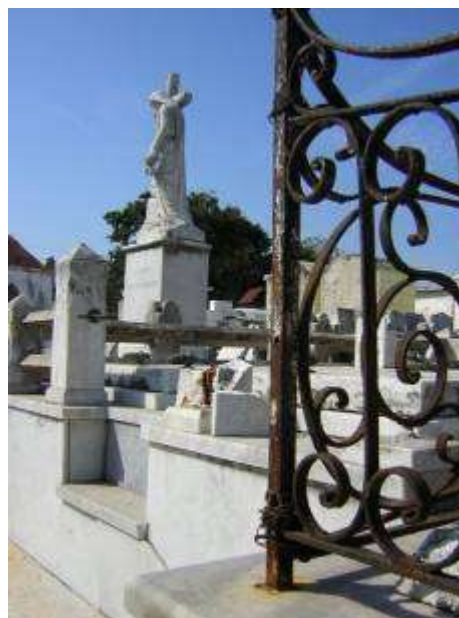
Fig. 13 Vista de panteones extendidos en Primer Tramo. Nótese manchas en el mármol y el estado de la reja de hierro y el resto de los adminículos decorativos.
