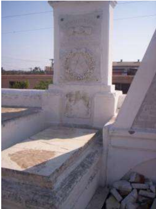
Fig. 10 Panteón de Salvador Cisneros Betancourt, Marqués de Santa Lucía. Obsérvese el estado de la lápida, luego de destruirse la de mármol original, cuyos restos se aprecian en el suelo.
