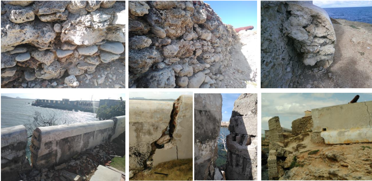
Fig. 12 Daños severos y tramos colapsados en parapetos de fondo y lado sur Fuente: tomadas por el autor (2019)
