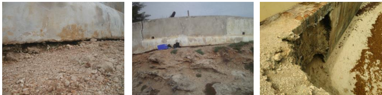
Fig. 8 Deterioros en la subestructura Fuente: Tomadas por el autor (2019)
