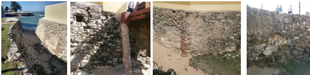
Fig. 11 Deterioros en muros de fosos Fuente: tomadas por el autor (2019)
