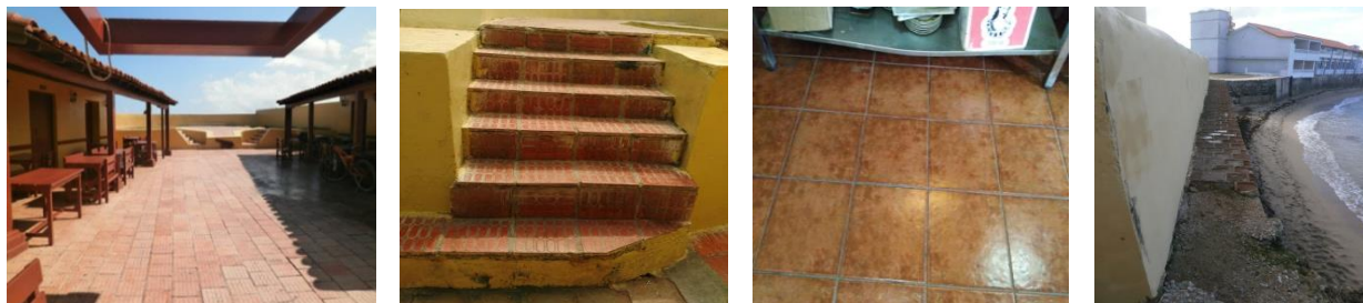
Fig. 15 Deterioros en pisos Fuente: tomadas por el autor (2019)
