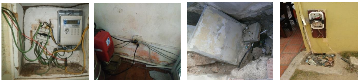
Fig. 18 Deterioros en las redes eléctricas Fuente: tomadas por el autor (2019)
