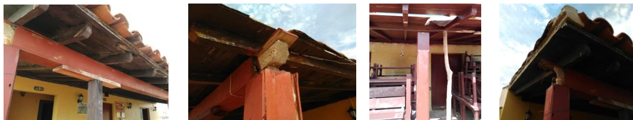
Fig. 9 Deterioros en la superestructura Fuente: Tomadas por el autor (2019)
