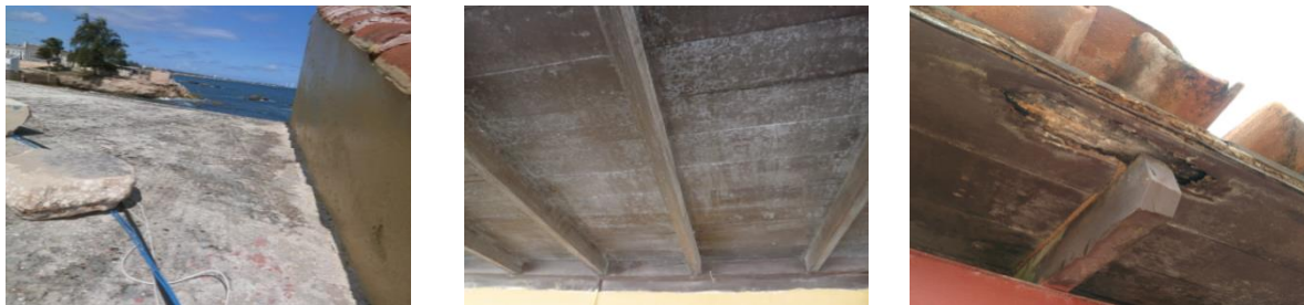
Fig. 10 Deterioros en la cubierta Fuente: tomadas por el autor (2019)
