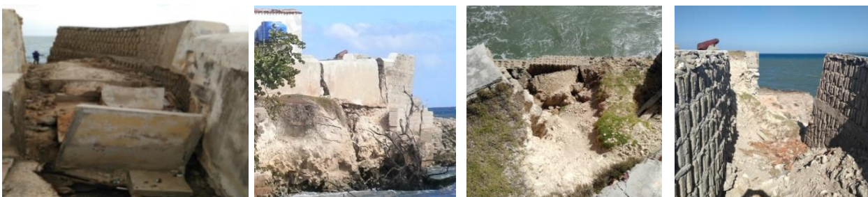
Fig. 13 Tramos colapsados en muro protector contra el oleaje sur Fuente: tomadas por el autor (2019)
