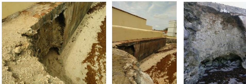
Fig. 14 Tramo afectado en muro protector contra el oleaje norte Fuente: tomadas por el autor (2019)
