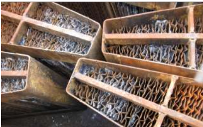
Fig. 5. Proceso de corrosión en los cestos fríos de los calentadores de aire regenerativos.
